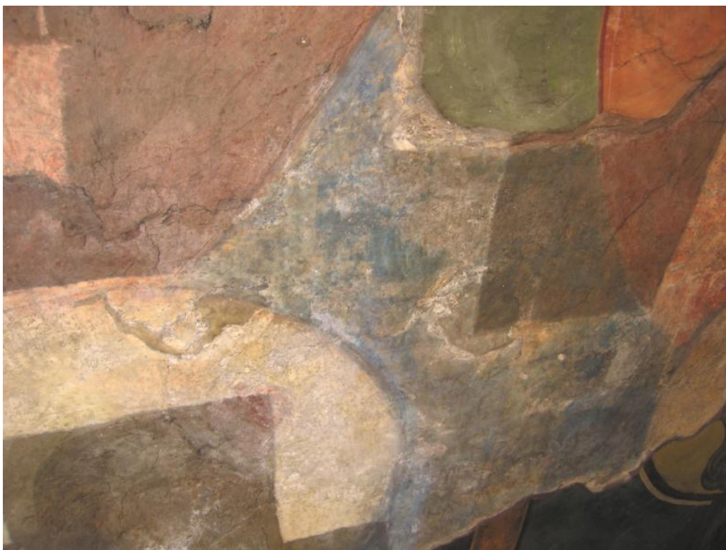
Фото 11. Владимир. Успенский собор. Южный люнет. Западный склон свода. Композиция «Богоявление». Плотный слой копоти и загрязнений на поверхности красочного слоя, утраты до грунта.
