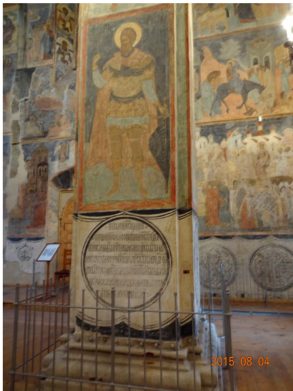
Фото 50а. Ярославль. Спасо-Преображенский собор. Увлажнение и высолы в нижней части юго-западного столба, угольные пробки для осушения кладки.
