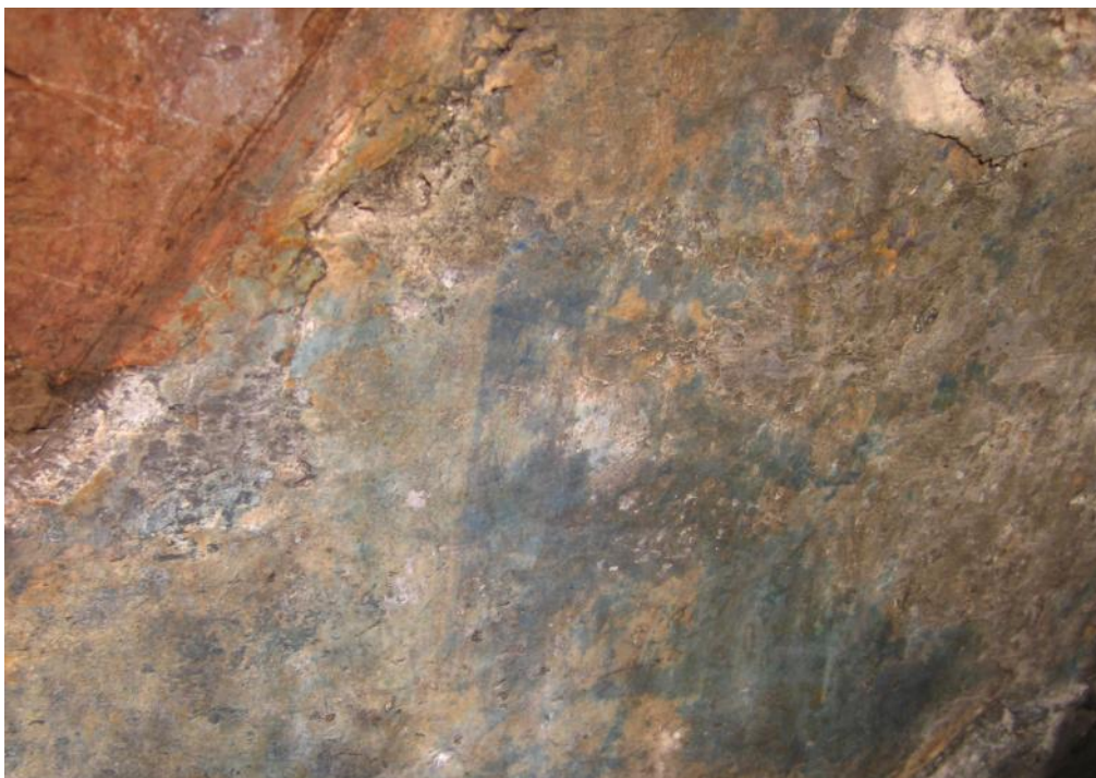
Фото 12. Владимир. Успенский собор. Южный люнет. Западный склон свода. Композиция «Богоявление». Фрагмент композиции. Плотный слой копоти и загрязнений, утраты красочного слоя до грунта.
